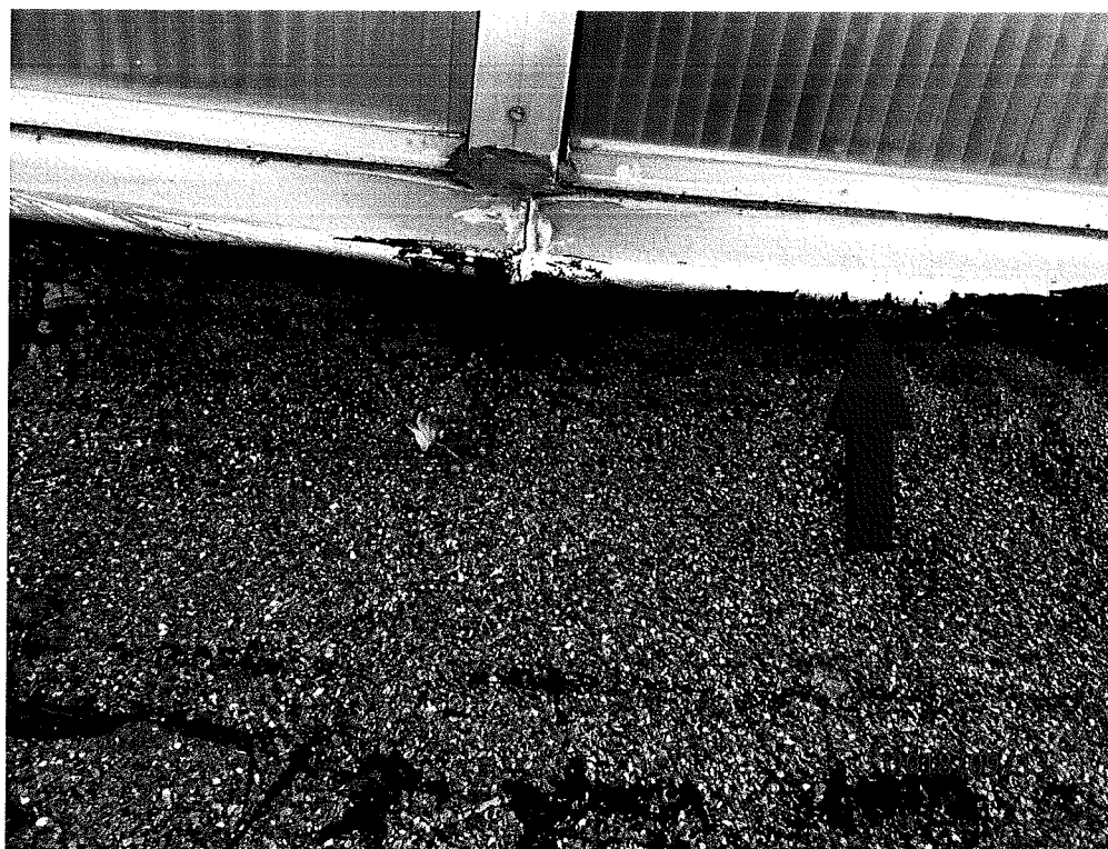
Fot. 32. Inne miejsce złego wykonania izolacji ścianki kolankowej świetlika. Spływająca z obróbki blacharskiej woda wlewa się bezpośrednio pod papę.
