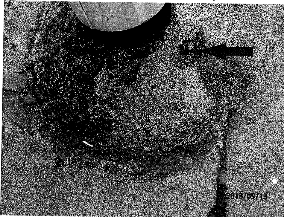
Fot. 14. Typowa usterka pokrycia z papy w miejscach przechodzenia wywiewzaków przez dach – prawdopodobna przyczyna nieszczelności pokrycia. Pęknięcie pokrycia z papy wskazuje na niską jakość użytego tego materiału. Nieprawidłowo wykonana obróbka wywiewki.
