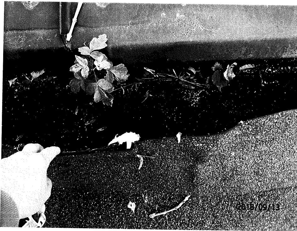
Fot. 7. Inne miejsce odklejenia od ścianki attyki od strony południowej paska papy. Duża wilgoć pod pasem papy sprzyja rozwojowi flory. Powyższa usterka jest typowa dla tego dachu i występuję praktyczne na całym obwodzie budynku.
