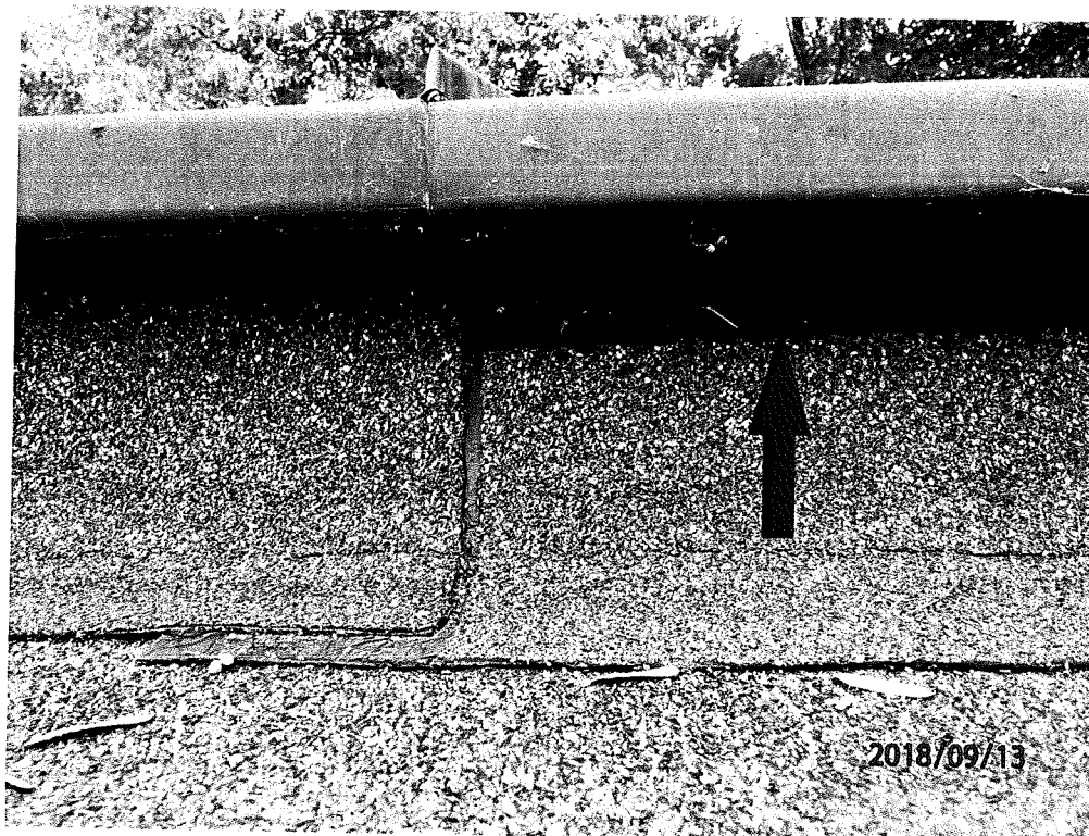
Fot. 6. Inne miejsce odklejenia od ścianki attyki paska papy. Powyższa usterka jest typowa dla tego dachu i występuję praktycznie na całym obwodzie budynku.
