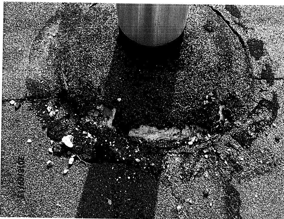
Fot.16. Inne miejsce przechodzenia wywiewzaka przez dach. Uszkodzenie powłoki bitumicznej – przyczyna przeciekania wody opadowej. Pęknięcie pokrycia z papy wskazuje na niską jakość użytego tego materiału. Nieprawidłowo wykonana obróbka wywiewki.
