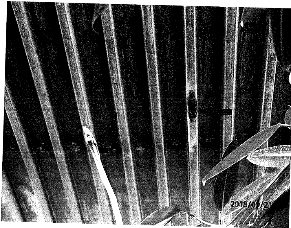
Fot. 41 Uszkodzenia w suficie świetlików. Korozja świadczy o nieszczelności pokrycia dachowego.
