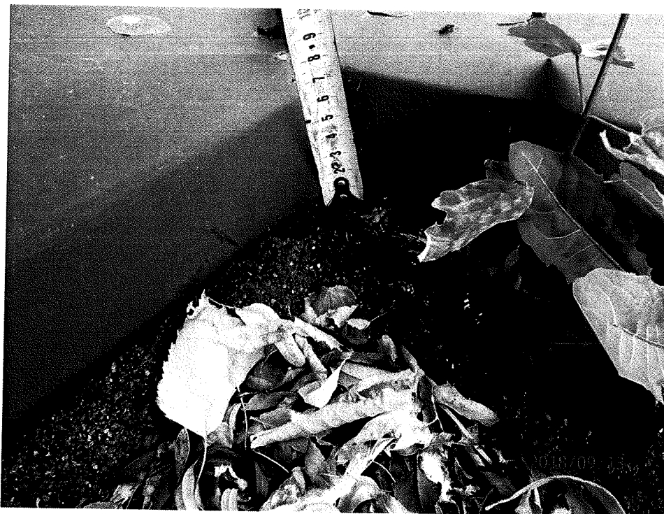
Fot. 8. Inne miejsce odklejenia od ścianki attyki od strony południowej paska papy. Duża wilgoć pod pasem papy sprzyja rozwojowi flory. Zbyt niska ścianka kolankowa. Powyższa usterka jest typowa dla tego dachu i występuję praktyczne na całym obwodzie budynku.
