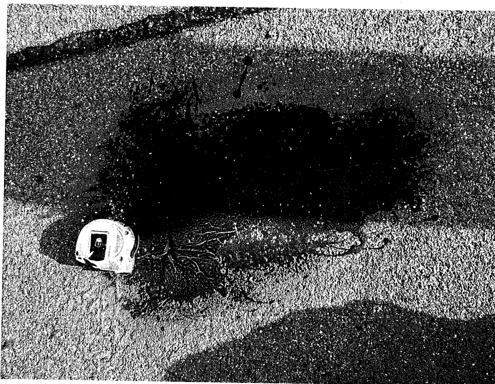
Fot. 20. Nieskuteczny sposób naprawy rozerwania papy poprzez smarowanie powłoką bitumiczną mało elastyczną. Uszkodzenie powinno być naprawione dodatkową łatą przyklejoną w miejscu uszkodzenia pokrycia.
