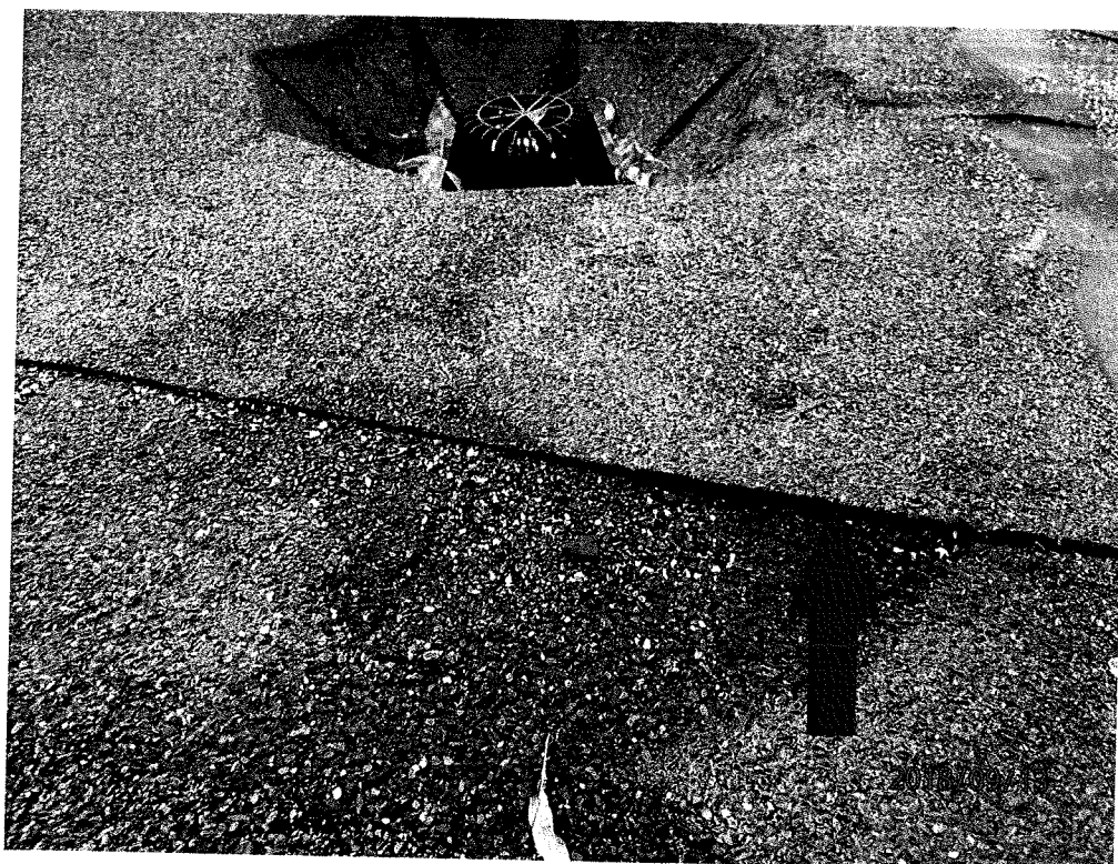
Fot. 30. Wadliwe wykonanie izolacji wokół wewnętrznego wpustu dachowego. Zaznaczono miejsce wnikania wód opadowych pod papę wpustu.
