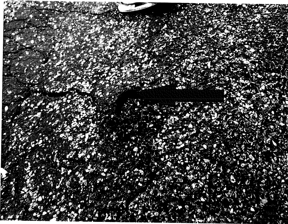
Fot. 15. Pęknięcie papy w miejscu powstania pęcherza powietrznego. Jest to niewątpliwie inne źródło możliwych przecieków.
